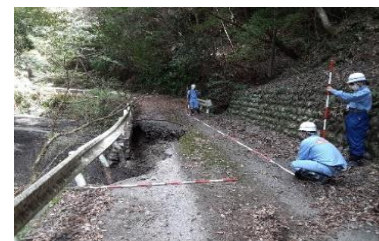
台風第15号により被災した静岡県 島田市でのTEC-FORCE活動
