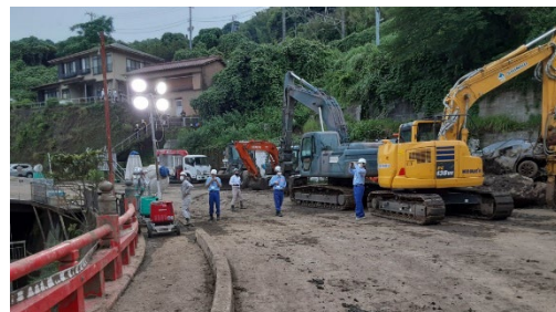
静岡県熱海市で発生した土石流災害 におけるTEC-FORCE活動(令和3年7月)
