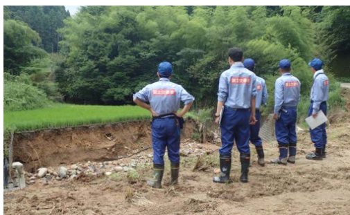
被災状況調査
