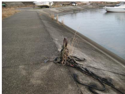
係留杭の設置による護岸損傷
