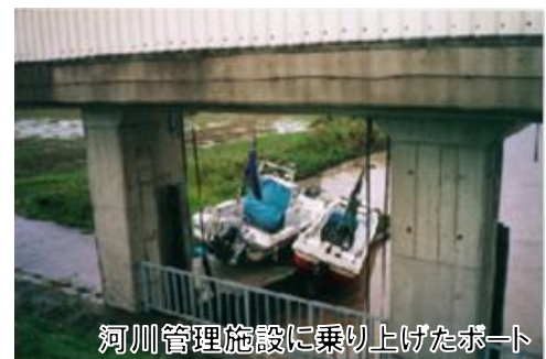
河川管理施設に乗り上げたボート 出典：国土交通省 福井河川国道事務所ホームページ
