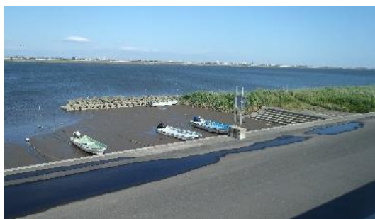
土砂堆積した変形護岸
