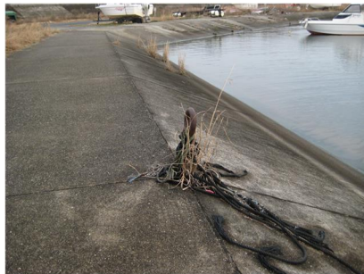
係留杭の設置による護岸損傷
