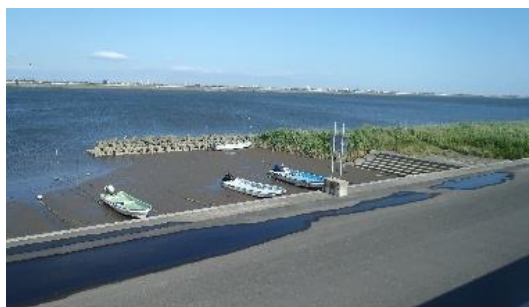
土砂堆積した変形護岸
