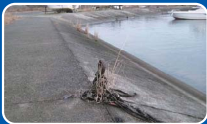
係留杭による護岸の損傷
