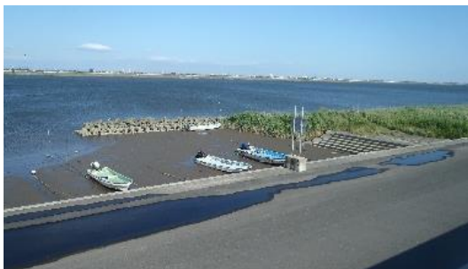
土砂堆積した変形護岸
