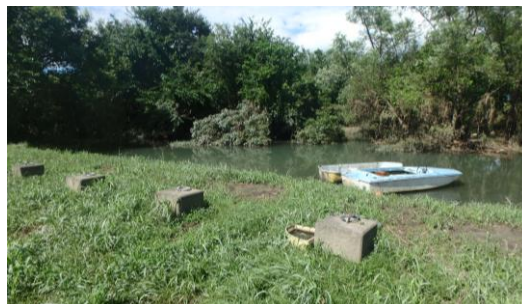
樹林化した変形護岸
