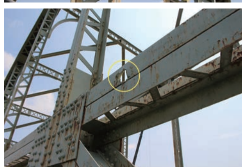
写真⑪ 機銃掃射で損傷を受けた伊勢大橋
