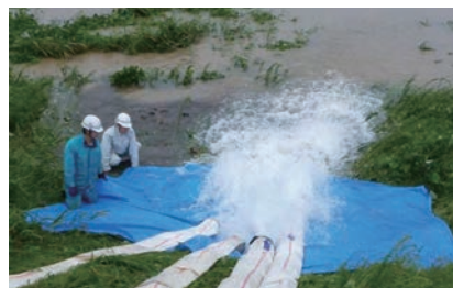
排水ポンプ車による排水活動 〈提供：木曾川上流河川事務所〉
