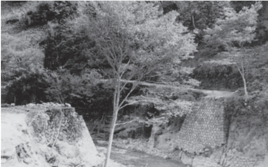
山崩れの後、崩落した諸家橋
