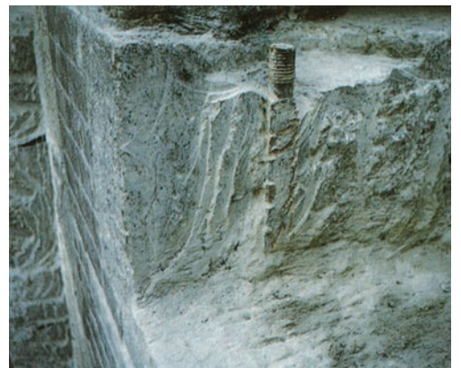
開閉装置固定アンカー 〈出典：『船頭平開門移築記念誌』〉
