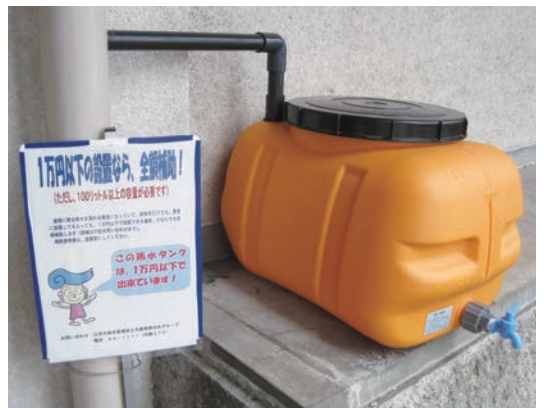
市役所に設置された雨水タンク 〈提供：江南市役所水道部下水道課〉
