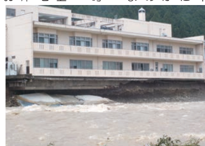
郡上市地域医療センターの被災状況 (提供：郡上市和良振興事務所)
