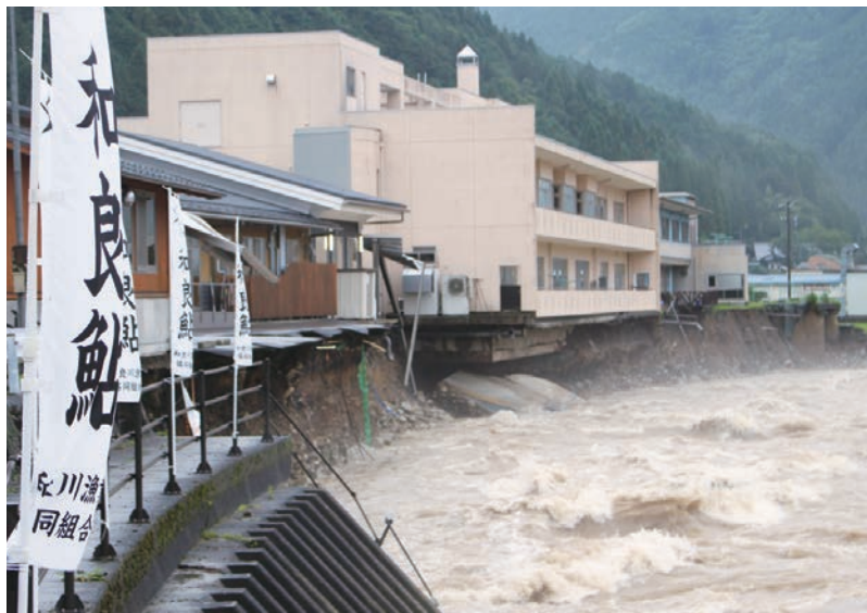
崩壊した和良振興事務所周辺の護岸〈提供：郡上市和良振興事務所〉
