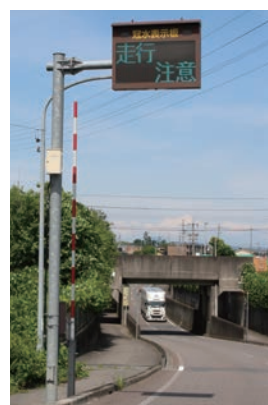
アンダーパスに設置された 電光表示板と遮断機
