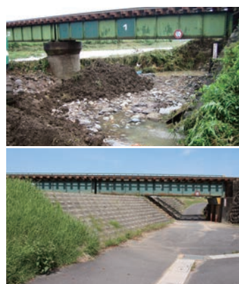
広見地区の決壊状況(上)と現在(下) (提供:可児市役所防災安全課)
