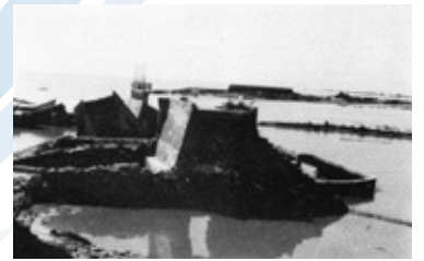
■ 海部海岸堤防の破壊状況
