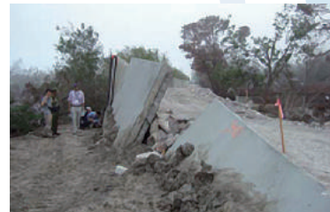
■ロンドン通り運河左岸破堤口上流端
