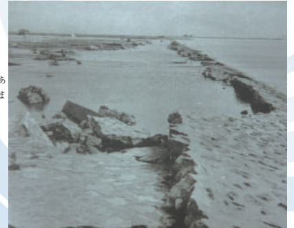
■ 破壊された城南海岸の堤防
