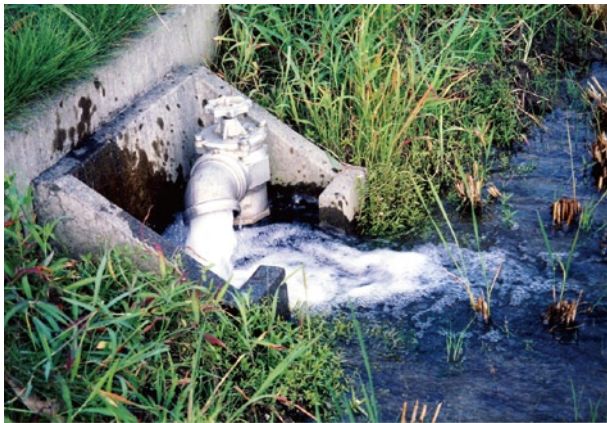
水田に引水するパイプライン
