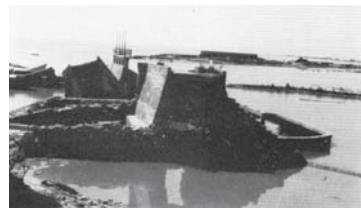
海部海岸堤防の破壊状況
