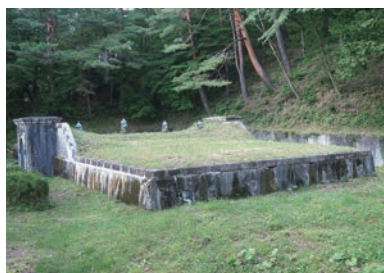
配水池（関山公園）
