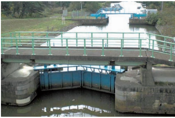
被災後の釜閘門（平成 23 年 3 月 16 日撮影）
