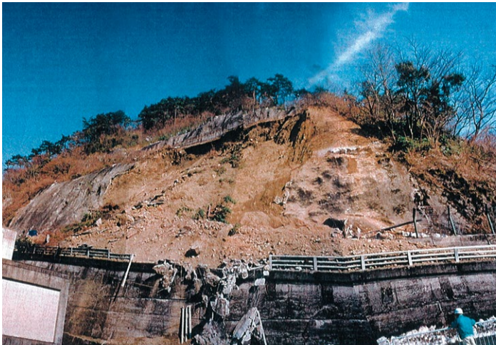
ダム左岸法面崩壊
