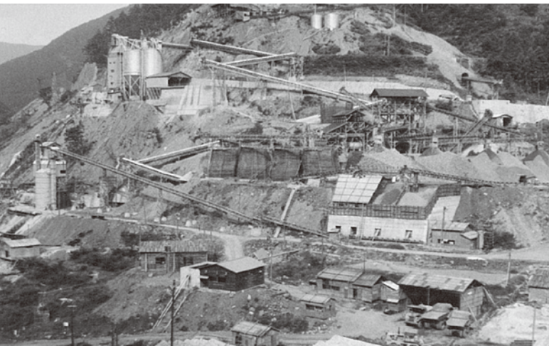
左岸プラント
