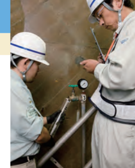
漏水計 ダム堤体内に設置した漏水計で、ダム堤体の漏水や湧水を測定しています。
