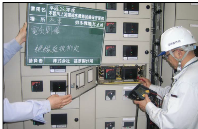
排水機場内の電気設備関係の点検 （福束排水機場：平成26年5月8日）
