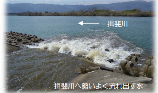
ポンプ起動により排水開始！
