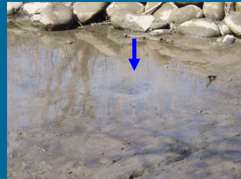
上流側で湧水が確認された。 (平成23年3月18日)
