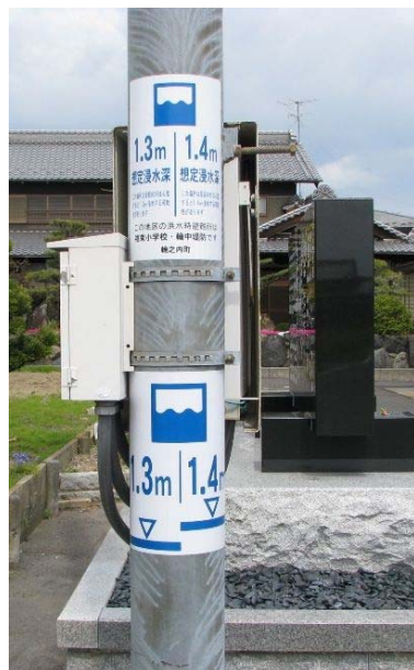
防災無線（既設置）
