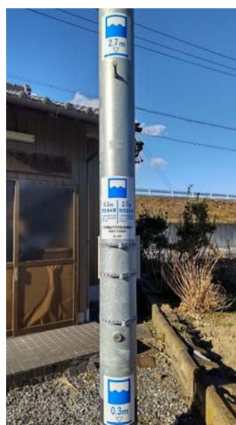
防災無線（今回設置）
