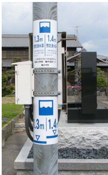
防災無線（既設置）
