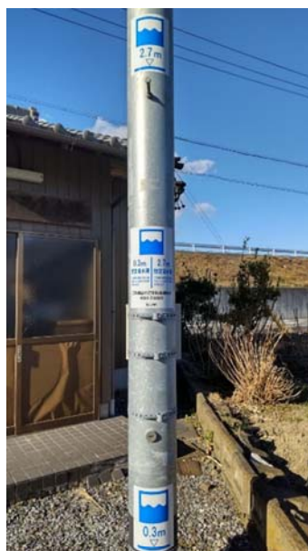
防災無線（今回設置）
