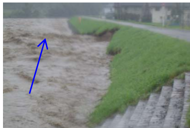
異常な侵食の発生
