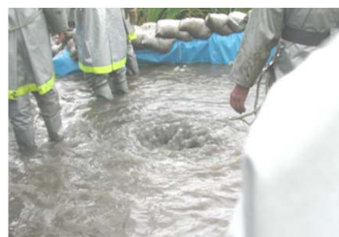
異常な漏水の発生
