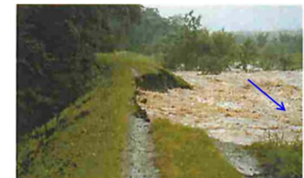
侵食の拡大による堤防決壊の恐れ
