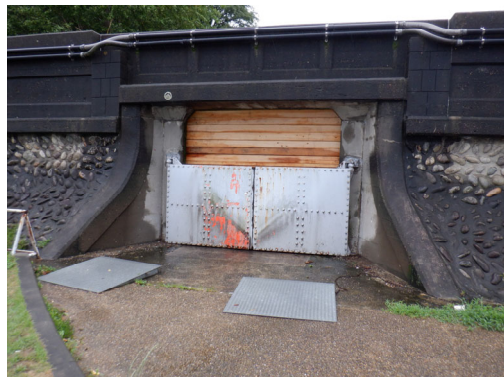
起陸閘の閉鎖状況
