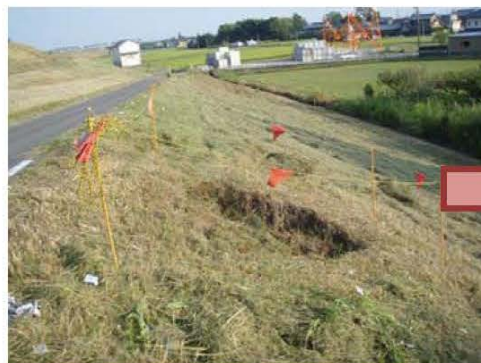
ていぼうのりめんかんぽつ ほっけん 堤防法面陥没の発見
