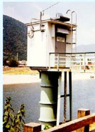
テレメータ水位観測所
