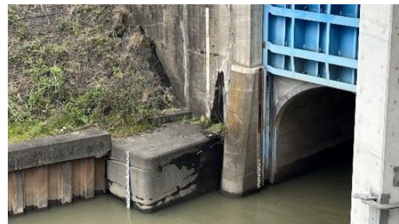
老朽化した樋門の取付護岸
