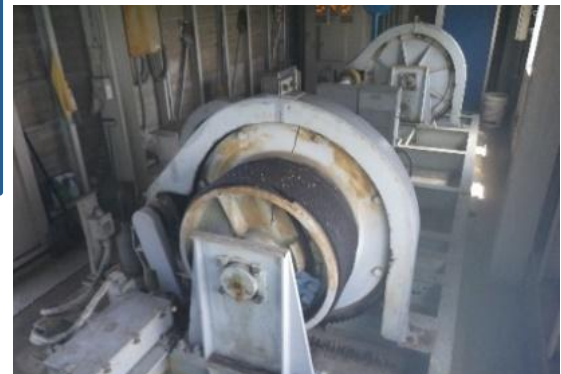
老朽化した開閉装置
