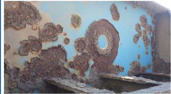
腐食した扉体
