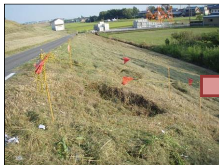
堤防法面陥没の発見
