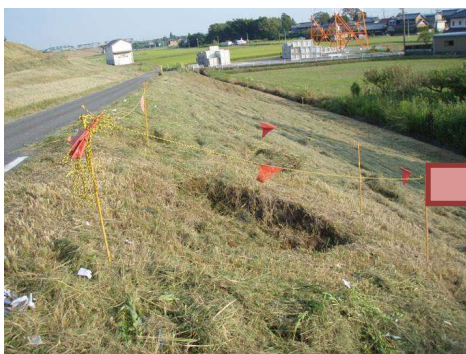
堤防法面陥没の発見
