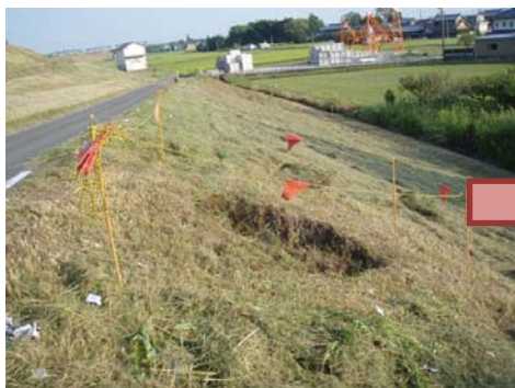
堤防法面陥没の発見
