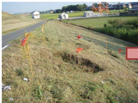
堤防法面陥没の発見
