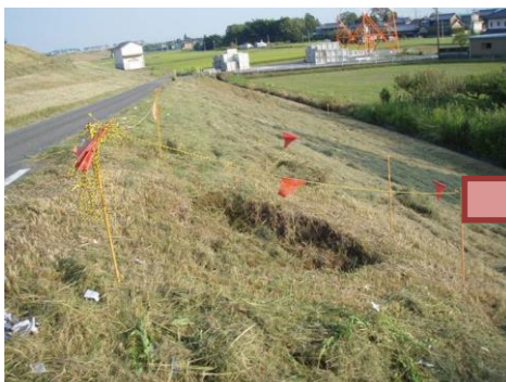
堤防法面陥没の発見
