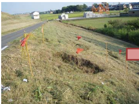
堤防法面陥没の発見
