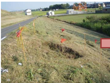
堤防法面陥没の発見
