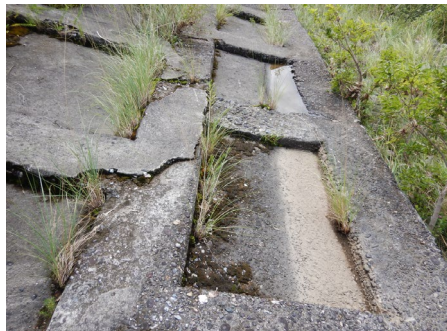
写真② コンクリートの剥離
