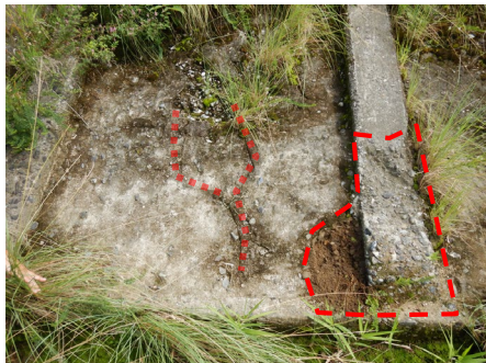
写真① 護岸のひび割れ・欠損
