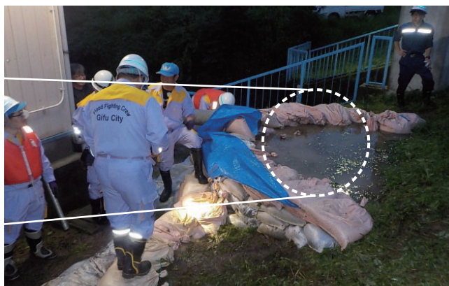
長良川左岸41.0km付近 基盤漏水
