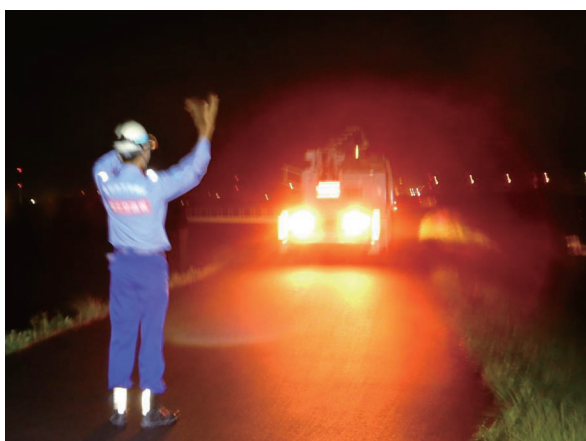
排水ポンプ車運用の状況
