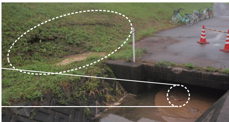
長良川右岸49.0k付近 堤防法崩れ
