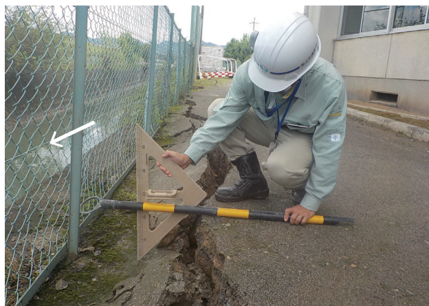
護岸の亀裂状況の確認
