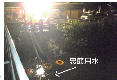
排水ポンプ車設置・稼働状況(7月8日) ▶
