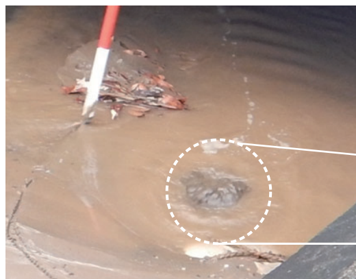
長良川右岸49.0k付近 基盤漏水
