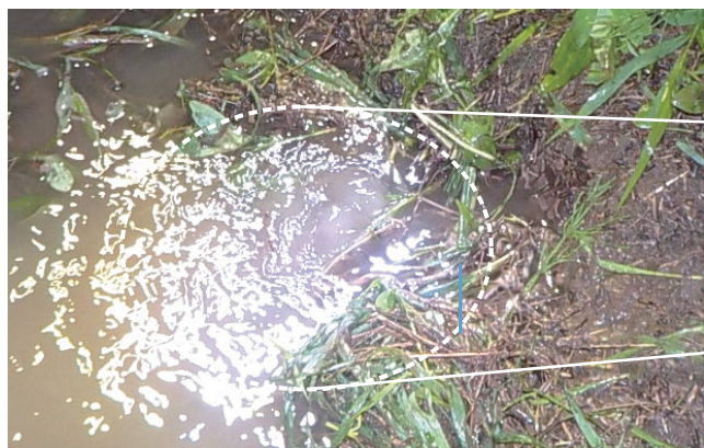
長良川左岸41.0km付近 基盤漏水
