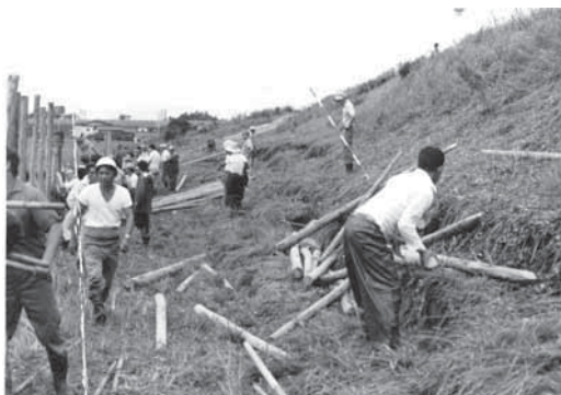
応急作業開始「杭打ち工法」が繰り広げられた ＝長良川堤（安八町）
