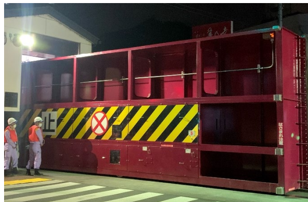
陸閘操作訓練(長良陸閘)
