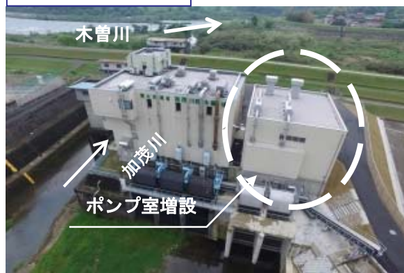
加茂川排水機場
