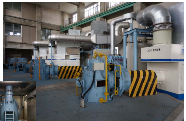
【排水機場屋内】
