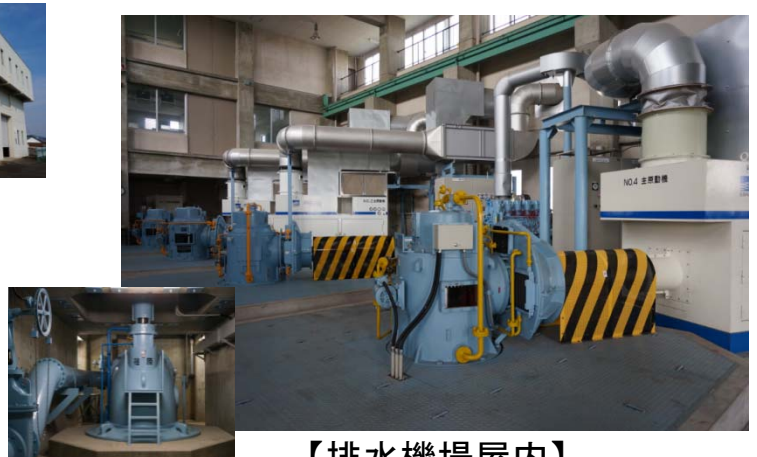
【排水機場屋内】
