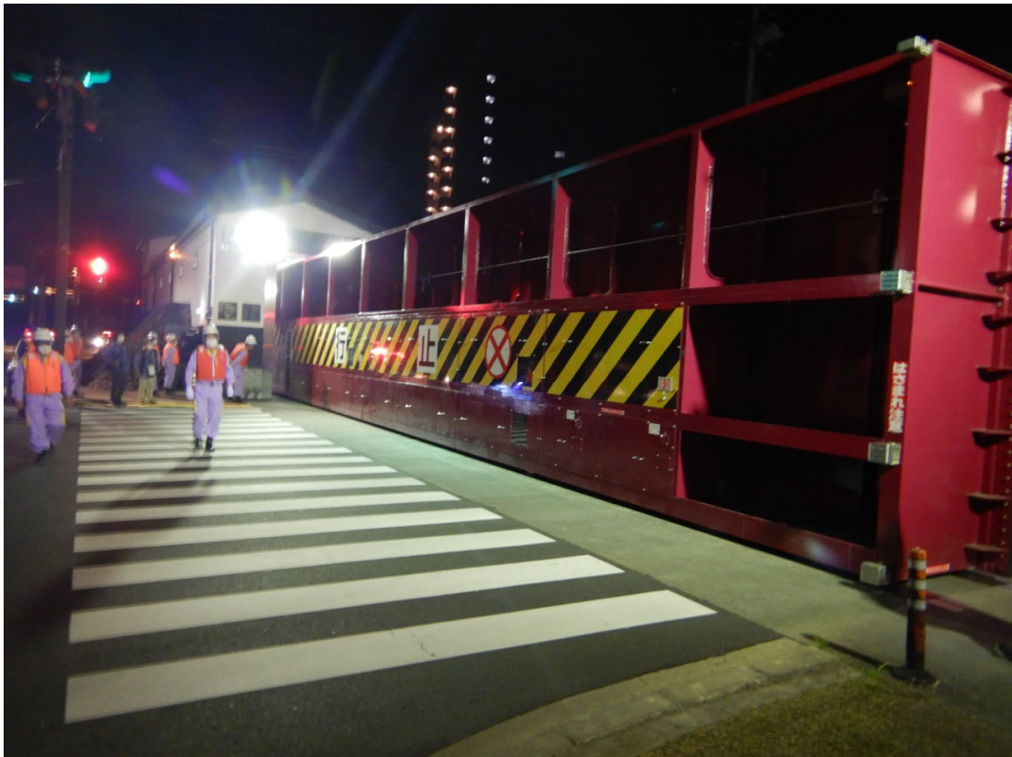
長良陸閘（閉鎖完了）
