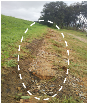
木曾川左岸67.8k 堤防川表の法崩れ状況
