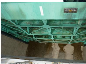
常用洪水吐ゲートの水密ゴムの老朽化（丸山ダム）
