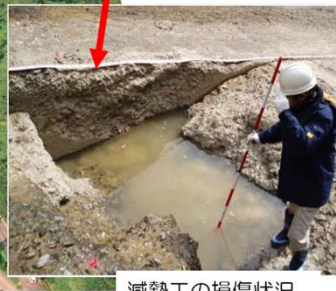
減勢工の損傷状況（横山ダム）
