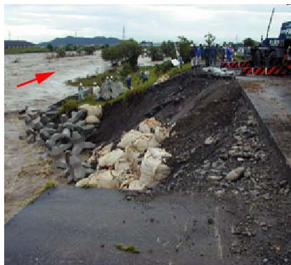
堤防の一部損傷
