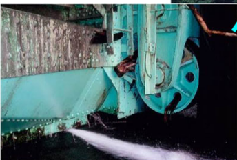
常用洪水吐ゲートの水密ゴムの損傷状況（丸山ダム）
