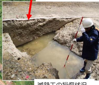
減勢工の損傷状況（横山ダム）
